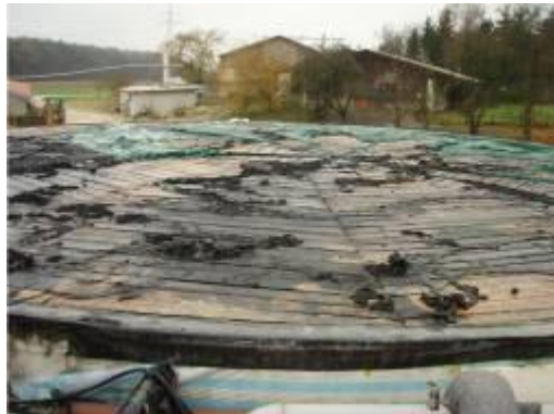
Abb. 9: Holzdeckenkonstruktion einer Biogasanlage nach Abbrand des Gasspeichers (Quelle: Anton Baumann)
