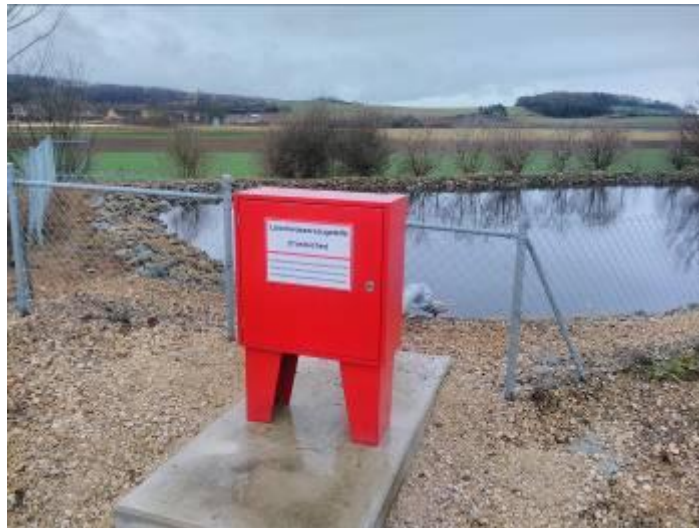
Abb. 6: Beispiel einer Löschwassersaugstelle (Quelle: Anton Baumann)
